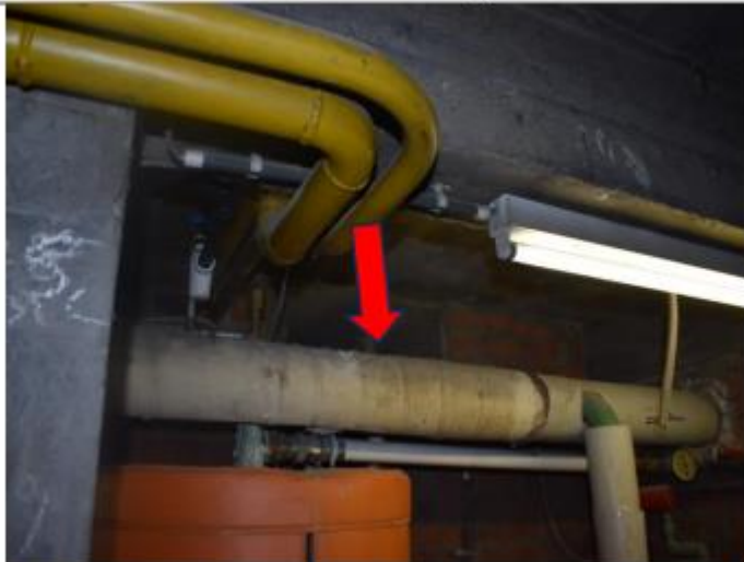
ZW-2023-2224-A-3, buisisolatie mengstaal stooklokaal rechts
