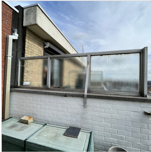
gebarsten draadglas achtergevel app 1002
