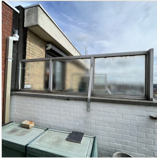
gebarsten draadglas achtergevel app 1002
