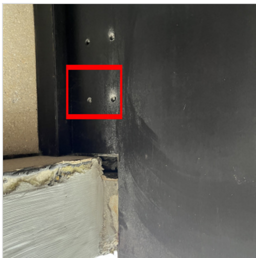
aansluitpunt wachtbuis fiber
